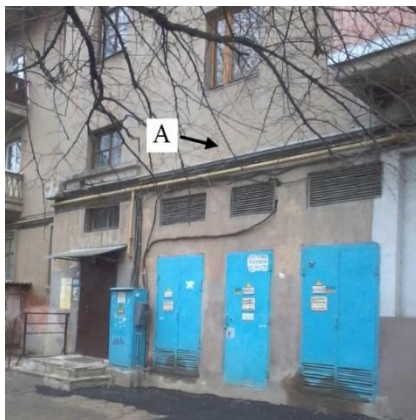
Рисунок 1 – Типовий житловий будинок старої забудови із вбудованою ТП 6/0,4 кВ
