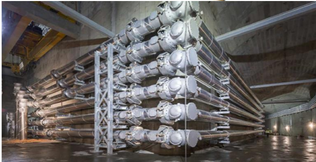
Рисунок 12 – Компоненти GIL системи виробництва Siemens та приклад їх монтажу під кутом 90° на гідроелектростанції Xiluodu Dam (Китай, є третьою за потужністю ГЕС у світі 13860 МВт) із довжиною GIL системи 12,5 км напругою 550 кВ потужністю 3950 МВА
