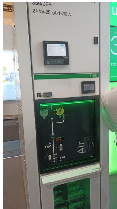
Рисунок 15 – Розподільний пристрій виробництва Schneider Electric із застосуванням екологічної SF 6 -free технології (фото зробив магістр кафедри «Електричні апарати» НТУ «ХПІ» Георгій Ламаш на виставці Hannover Messe (Німеччина, 22–26 квітня 2024 р.))
