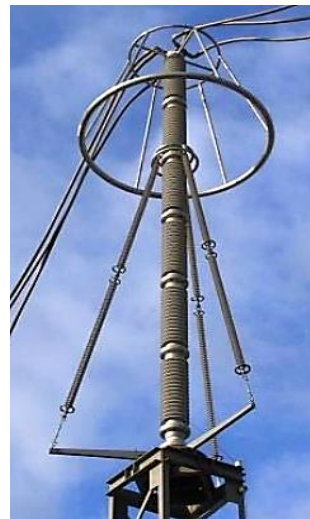
Рисунок 6 – Обмежувач перенапруги типу ОПНн-750 у складі ОРУ-750 кВ на Запорізькій АЕС [9]
