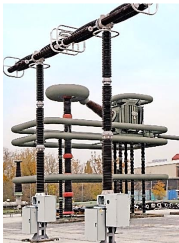
Рисунок 3 – Зовнішній вигляд тороїдальних екранів обладнання підстанції 800 кВ виробництва SIMENS [5]
