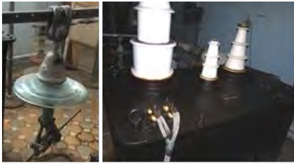
Рисунок 1 – Ізолятор (зліва), підвищувачи трансформатор (справа)
