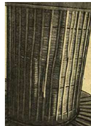
Рис. 2 – Деформированная обмотка трансформатора из-за воздействия токов короткого замыкания
