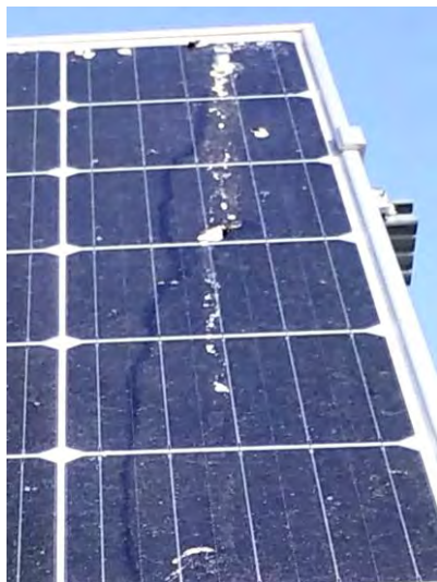
Рисунок 10 – Забруднення поверхні ФЕМ екскрементами птахів
