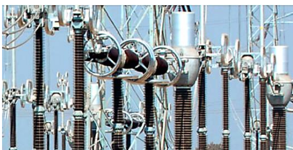
Рисунок 1 – Електроенергетичне високовольтне обладнання відкритого розподільного пристрою підстанції 800 кВ GE VERNOVA [4]
