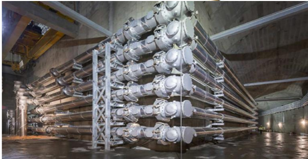
Рисунок 12 – Компоненти GIL системи виробництва Siemens та приклад їх монтажу під кутом 90° на гідроелектростанції Xiluodu Dam (Китай, є третьою за потужністю ГЕС у світі 13860 МВт) із довжиною GIL системи 12,5 км напругою 550 кВ потужністю 3950 МВА
