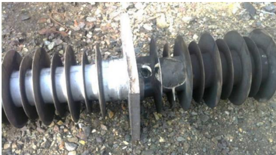
Рисунок 2 – Полімерний прохідний ізолятор, що вийшов із ладу через електричне старіння ізоляції
