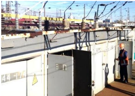
Рисунок 1 – Пункт угруповання станції Львів, укомплектований керамічними та полімерними прохідними ізоляторами.
