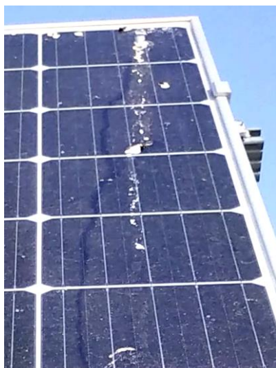
Рисунок 10 – Забруднення поверхні ФЕМ екскрементами птахів
